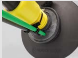
03 Dichtflansch mit Gashaueinführung und LWL
